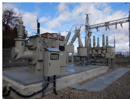
屋外変電設備
